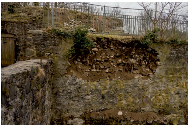
Abb1. Mauerschaden am Järgergemach
